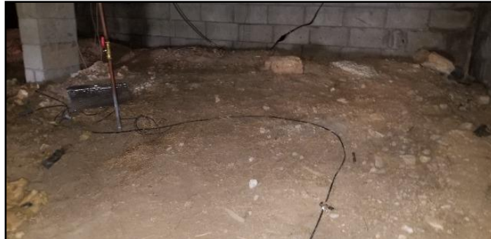
No vapor barrier
